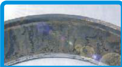
(ÉCAILLAGE) DÉCAPAGE CAUSÉ PAR L'EAU
